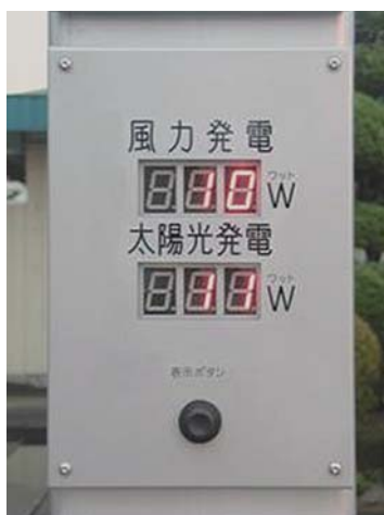
発電量表示装置
