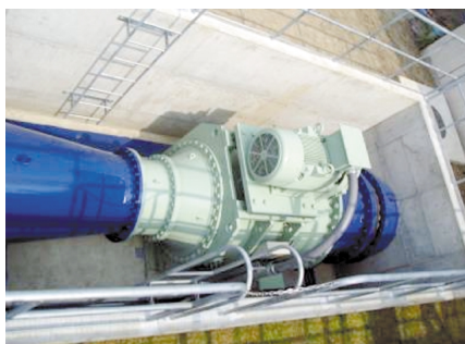
図-5 下水処理場に設置した例(2)
