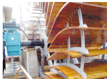
図-9 下掛け水車の永久磁石発電機
