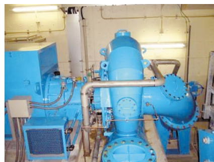
図-3 長大配管の末端に設置
