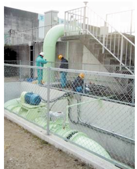
図-4 下水処理場に設置した例(1)
